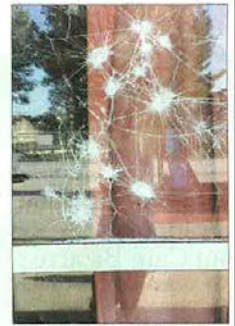
■ Huit fenêtres ou portes-fenêtres visées par des jets de pierres.
